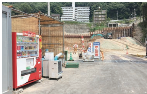
▲建設現場に設置されたアダプト支援自販機
